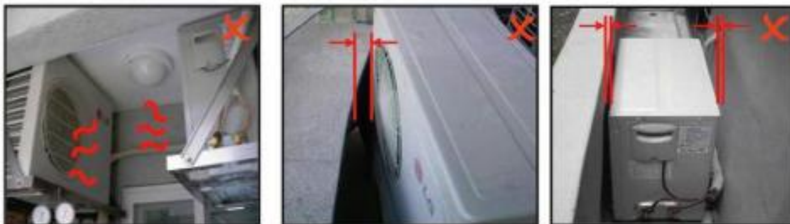
Rys. 4. Przykłady nieprawidłowego montażu
