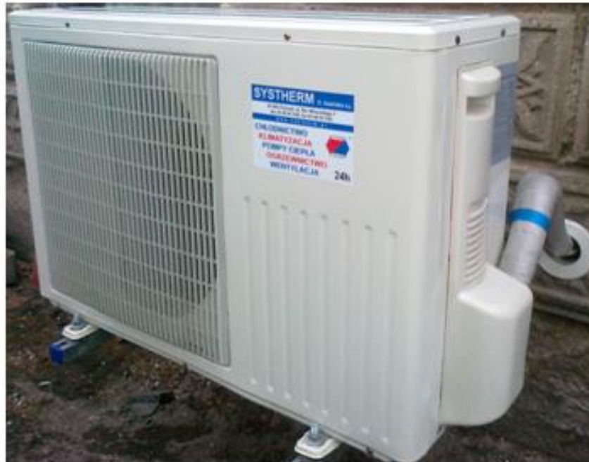
Rozeta z rurą osłonową zamontowana w ścianie od strony zewnętrznej
