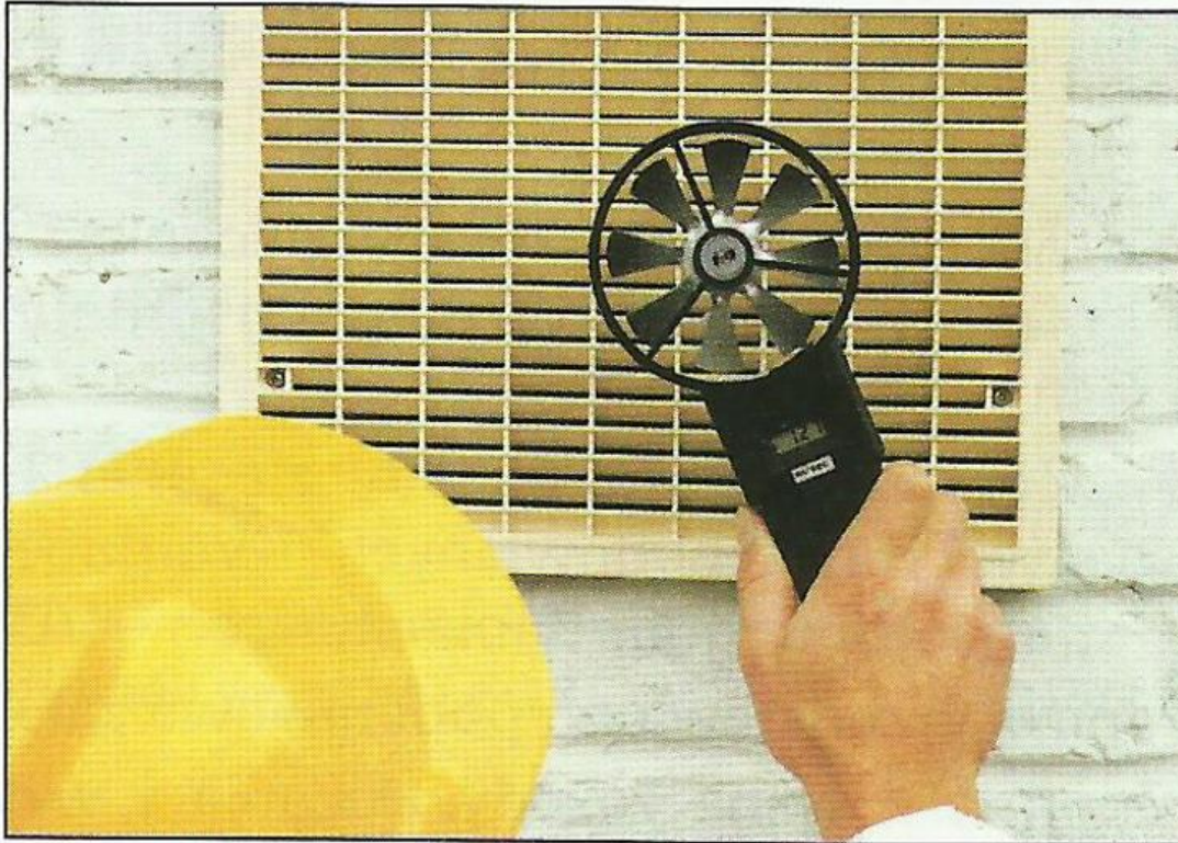
2 Pomiar prędkości przepływu przy kratce za pomocą anemometru skrzydełkowego
